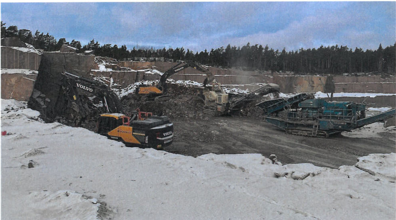
Kuva 2. Ympäristömelumittausten aikana alueella ollut esi- ja jälkimurskain. Louhetta syötettiin kaivinkoneella esimurskaimeen. Kuvassa on myös rikotin, joka ei ollut käytössä mittausten aikana.
